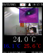
HVAC 溫控系统 冷熱出風口測溫
