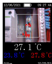
精確查找電路中 的「熱」位置， 如：母線連接
