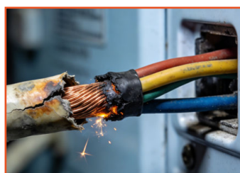
● 電線老化, 破損導致短路產生電弧, 火花引起火災
